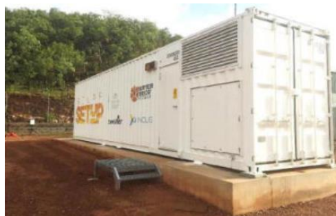
Abbildung 4: Beispielfoto eines Batteriespeichercontainers. Quelle: ABO Wind AG.
