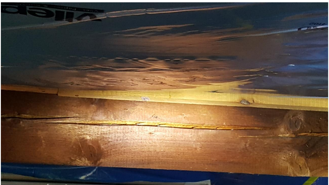
Abbildung 16: Im Dachgebälk konnten z.T. flache Spalten und Ritzen festgestellt werden.
