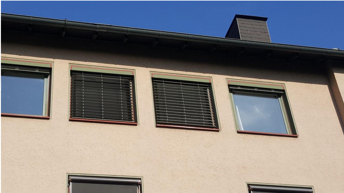
Abbildung 10: Die Fenster des Gebäudes an der Uerdinger Str. 67 sind mit Jalousien ausgestattet.
