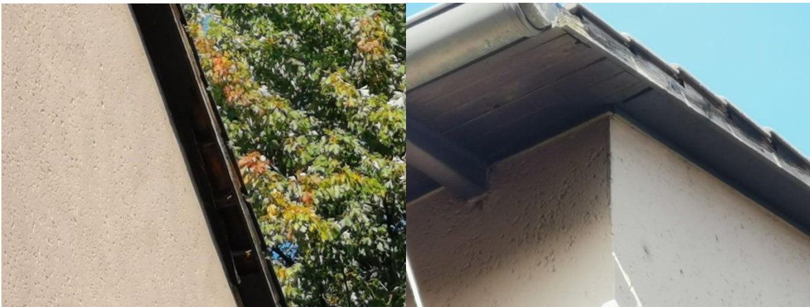
Abbildung 9: Im Dachübergangsbereich befinden sich Spalten, Ritze und Lücken, die potenzielle Quartiermöglichkeiten für Fledermäuse bieten. Es fanden sich allerdings keine Spuren, die auf eine aktuelle oder zurückliegende Besiedlung hinweisen würden.
