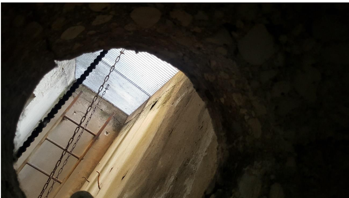
Abbildung 18: Die Zugänge zum Keller sind mit Gitter verschlossen.
