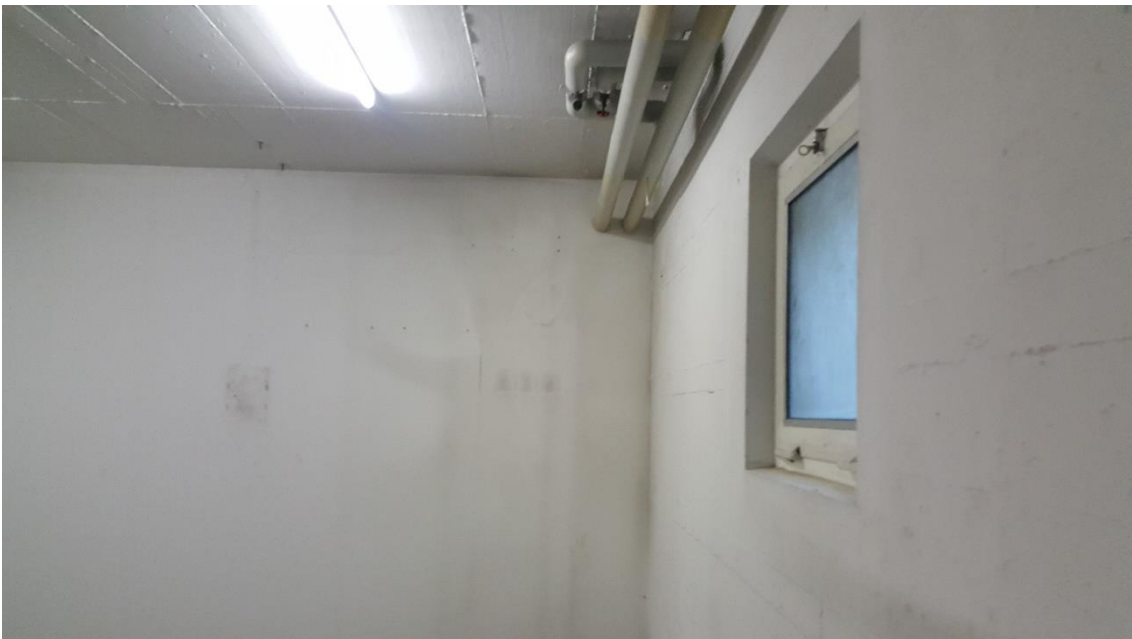
Abbildung 20: Vorhandene Kellerfenster waren zum Zeitpunkt der Begehung verschlossen, so dass keine Einflugmöglichkeiten für Tiere vorhanden sind.
