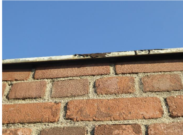
Abbildung 33: Die Fensterbänke und Dachabschlüsse sind dicht gemauert oder mit Bauschaum ausgespritzt und bieten keine Hohlräume.
