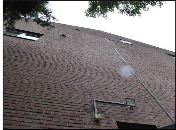
Abbildung 37: Intakte Fassadenbereiche prägen die Gebäude. Es sind keine Nester, Nischen oder Nisthilfen vorhanden.
