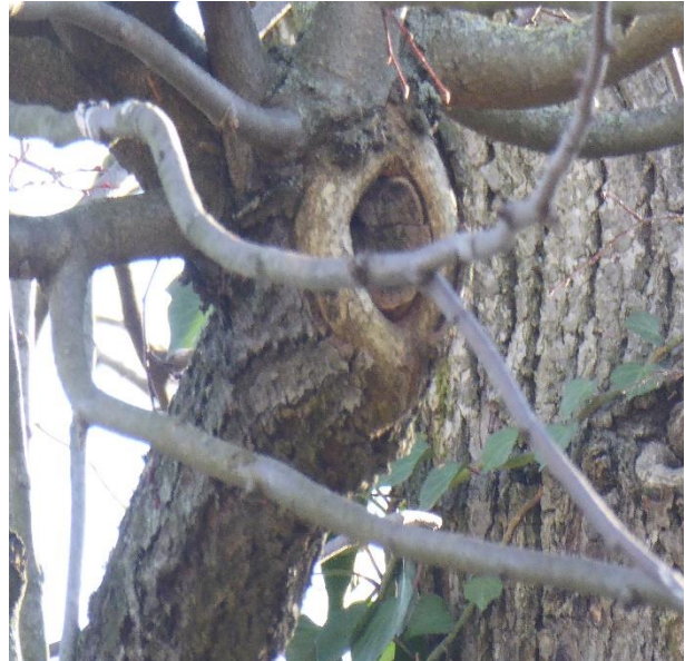
Abbildung 27: Zugewachsene Faulhöhle in Baum Nr.10.
