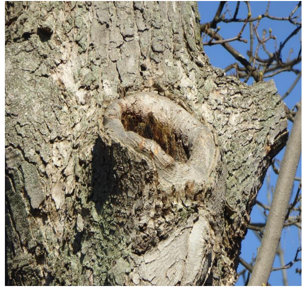
Abbildung19: Zugewachsene Faulhöhle in Baum Nr.01.
