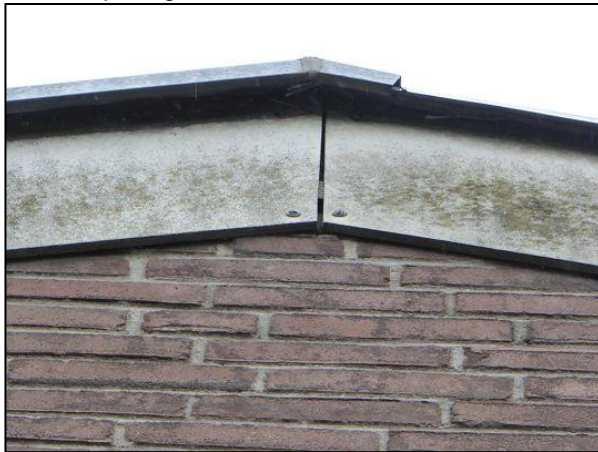
Abbildung 32: Die Blechattika liegt flach auf und bietet keine Hohlräume oder Spalten.
