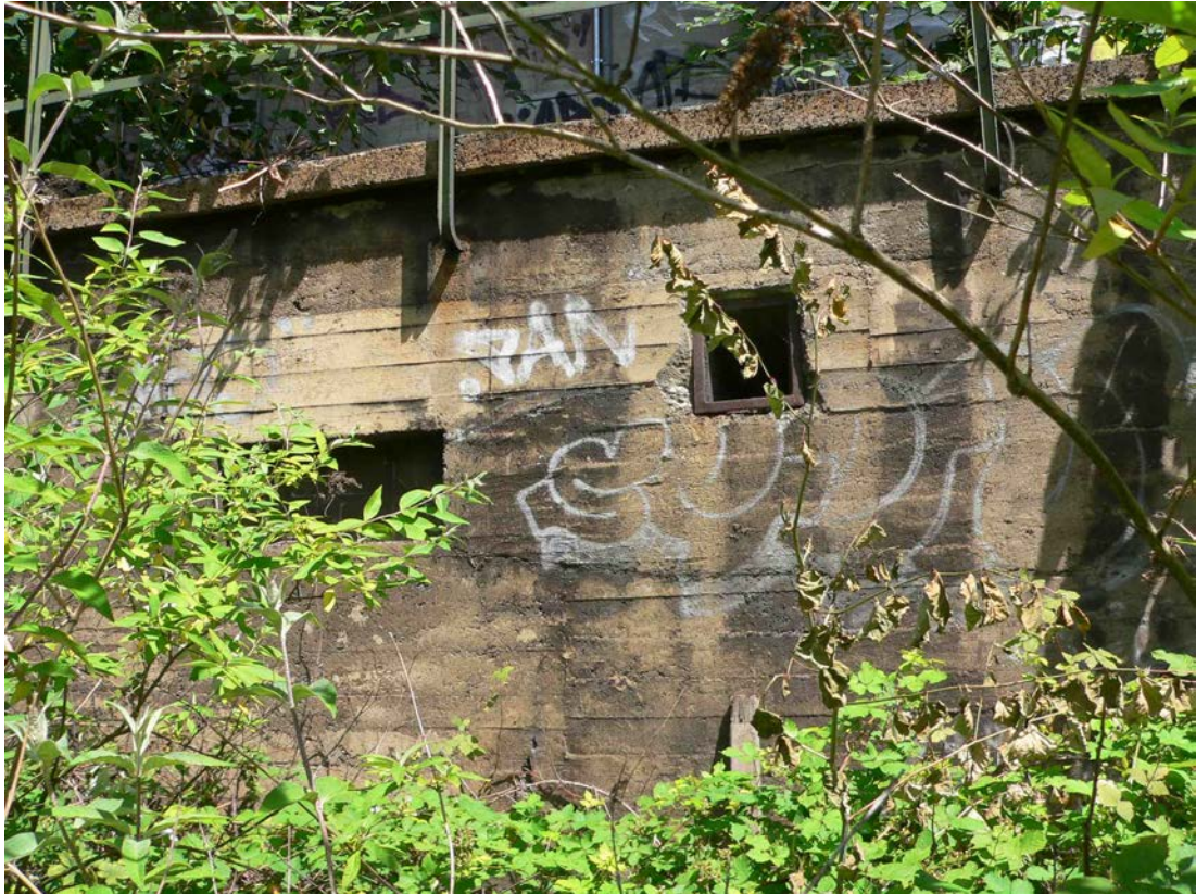
Abb. A6: Öffnung in der Stützmauer hin zum Bahnhof Düsseldorf-Wehrhahn mit potenzieller Funktion als Fledermausquartier
